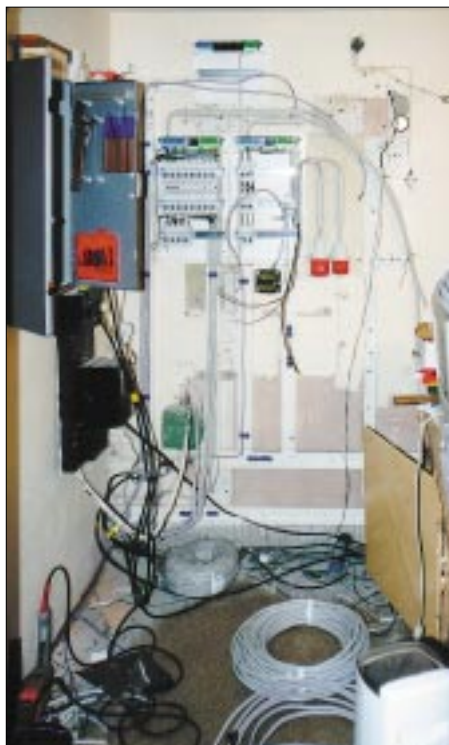
Bild 3: Wenn es im Shack schon keinen dicken Strom gibt, können auch die Kabel erneuert werden. Kupfer anstelle Alu war die erste Parole und die zweite besagte, ein paar Drähte mehr dürfen es auch sein. So entsteht die neue Kraftzentrale.
